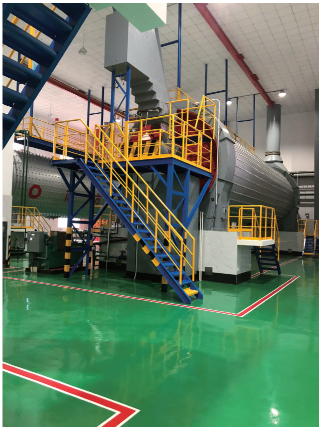
海盐南方水泥粉磨车间
